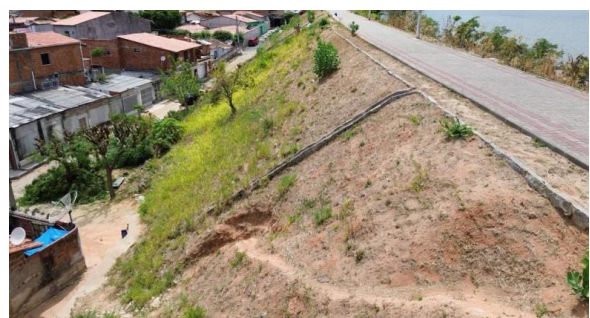
Figura 6 – Erosão no Talude.
