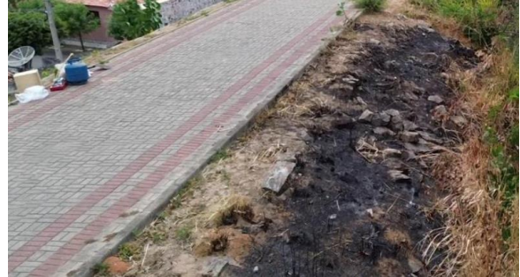
Figura 9 – Ausência de meio fio ao longo do Talude.
