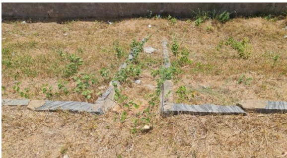
Figura 11 – Descida de água obstruída.
