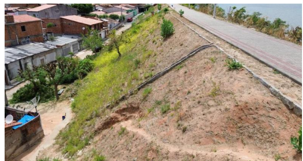
Figura 6 – Erosão no Talude.
