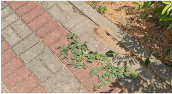
Figura 8 – Desalinhamento do meio fio.
