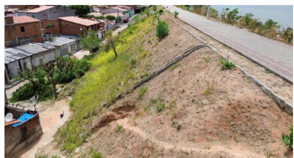
Figura 6 – Erosão no Talude.
