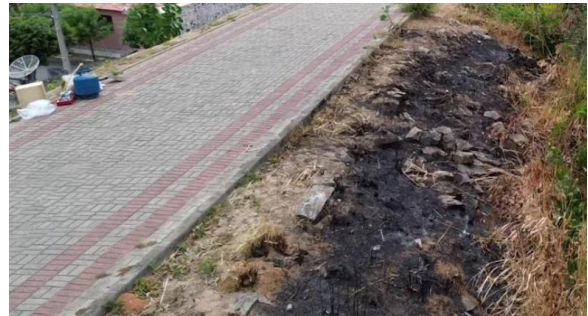
Figura 9 – Ausência de meio fio ao longo do Talude.
