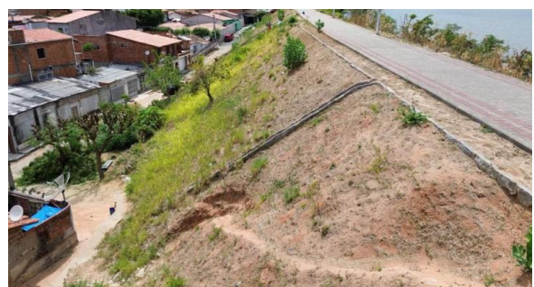
Figura 6 – Erosão no Talude.
