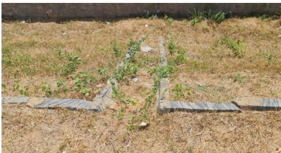
Figura 11 – Descida de água obstruída.
