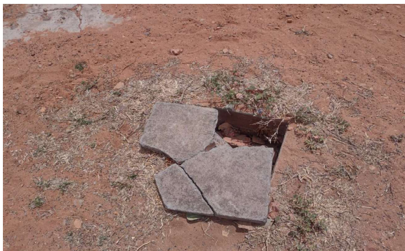
FOTO 16 – TAMPA DE CAIXAS DE INSPEÇÃO ELÉTRICA DANIFICADAS
