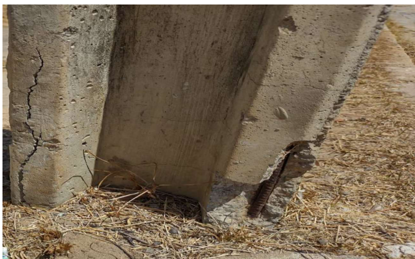
FOTO 13 – POSTES EXISTENTES DANIFICADOS
