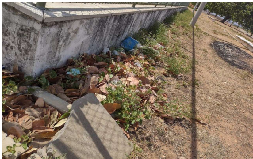
FOTO 14 – PINTURA DESGASTADA DA MURETA DA ARENINHA
