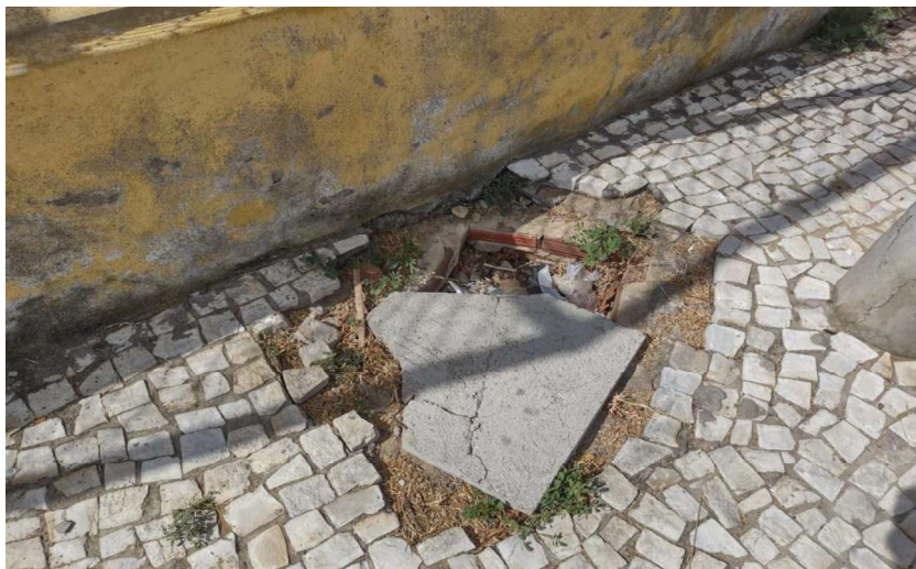
FOTO 12 – TAMPA CAIXA DE INSPEÇÃO ELÉTRICA DANIFICADA
