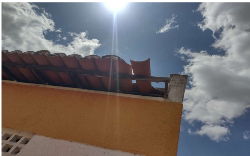
FOTO 06 – TELHADO VESTIÁRIO COM VÁRIAS TELHAS QUEBRADAS .
