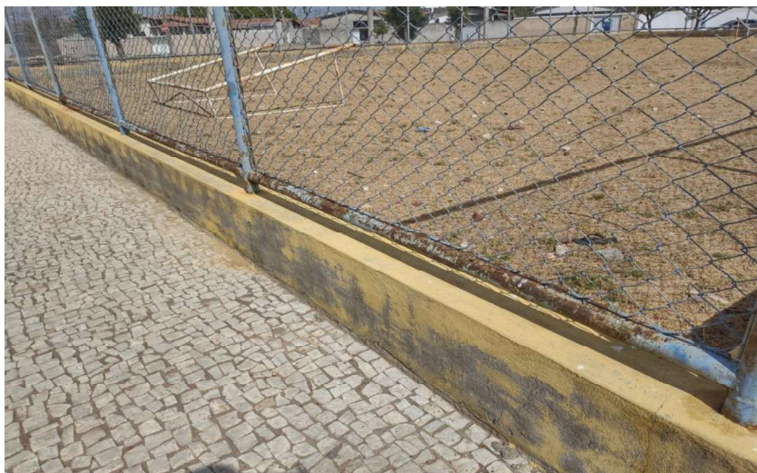
FOTO 02 – ALAMBRADO DANIFICADO COM CORROSÃO
