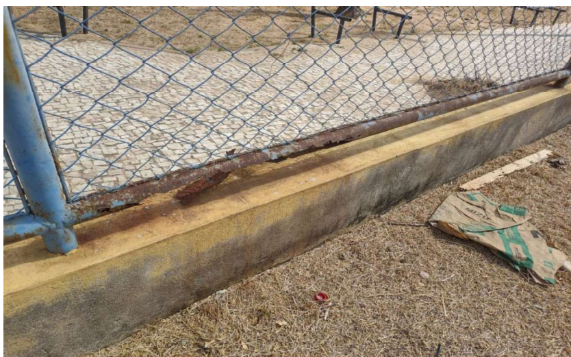
FOTO 01 – ALAMBRADO DANIFICADO COM CORROSÃO
