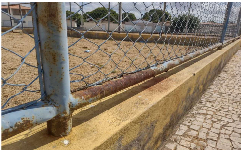
FOTO 04 – ALAMBRADO DANIFICADO COM CORROSÃO
