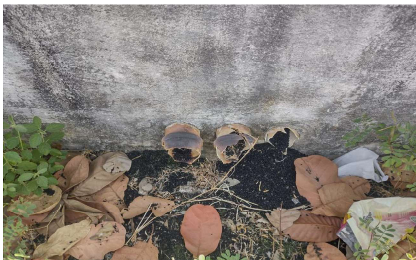
FOTO 07 – TUBOS DE DRENAGEM DANIFICADOS
