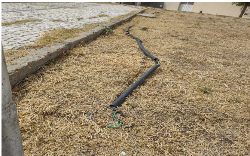
FOTO 10 – INSTALAÇÕES ELÉTRICAS DANIFICADAS (ELETRODUTOS EXPOSTOS, QUEBRADOS EM VÁRIOS LOCAIS E FIAÇÕES EXPOSTAS, DESEMCAPADAS E QUEBRADAS DEVIDO A EXPOSIÇÃO AO SOL).
