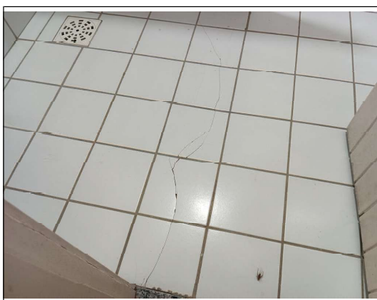
Foto 25 - Piso cerâmica com deformações.
