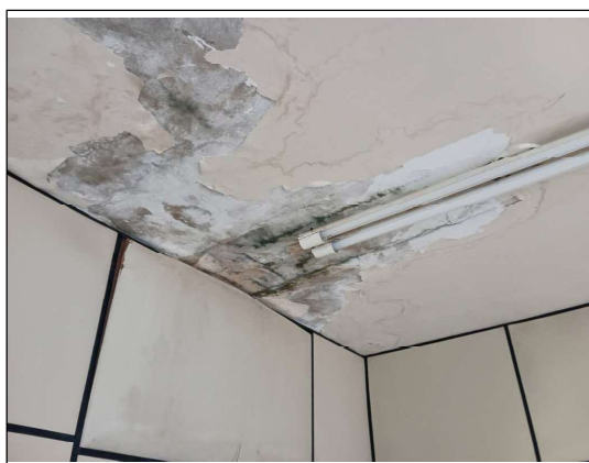
Foto 18 - Infiltração nas lajes e instalações.
