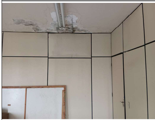
Foto 20 - Infiltração nas lajes e instalações.
