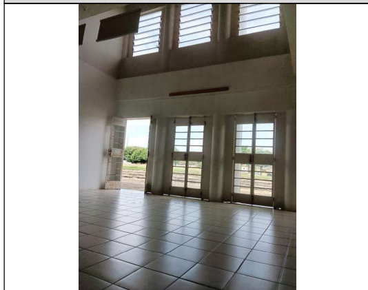
Foto 65 - Esquadrias metálicas a recuperar.
