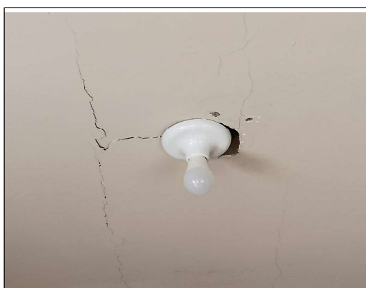
Foto 30 - Infiltração nas lajes e instalações.
