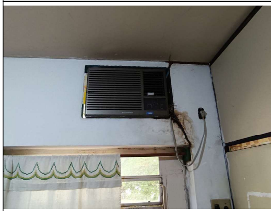
Foto 51 - Instalações de ArCondicionado.
