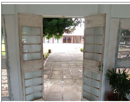
Foto 63 - Esquadrias metálicas a recuperar.
