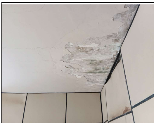
Foto 29 - Infiltração nas lajes e instalações.
