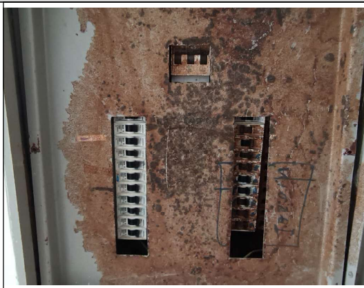
Foto 59 - Quadro de distribuição de energia.
