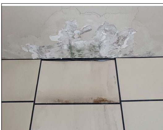
Foto 31 - Infiltração nas lajes e instalações.
