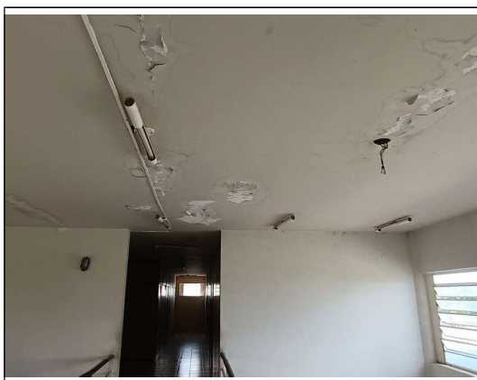
Foto 35 - Infiltração nas lajes e instalações.
