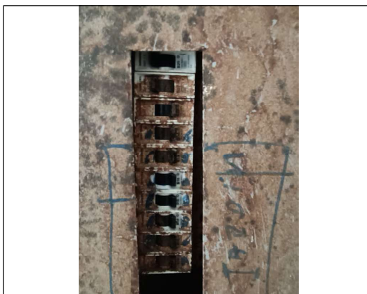
Foto 61 - Quadro de distribuição de energia.
