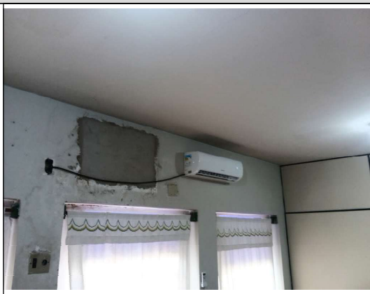
Foto 66 - Instalações de Ar-Condicionado.
