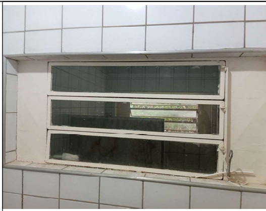
Foto 27 - Esquadrias metálicas a recuperar.
