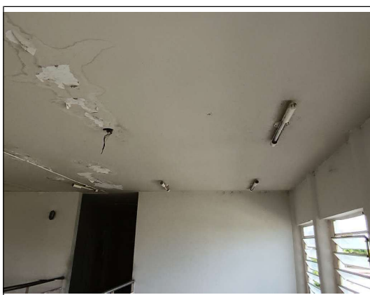
Foto 37 - Infiltração nas lajes e instalações.
