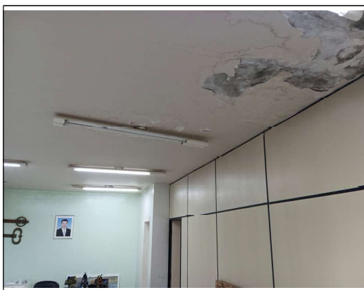
Foto 23 - Infiltração nas lajes e instalações.
