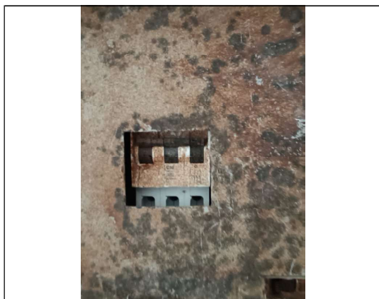
Foto 60 - Quadro de distribuição de energia.
