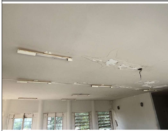
Foto 38 - Infiltração nas lajes e instalações.
