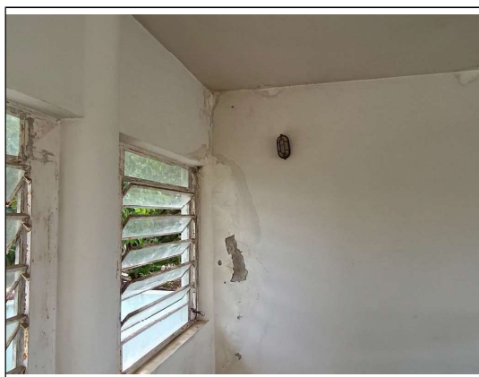
Foto 34 - Esquadrias metálicas a recuperar.
