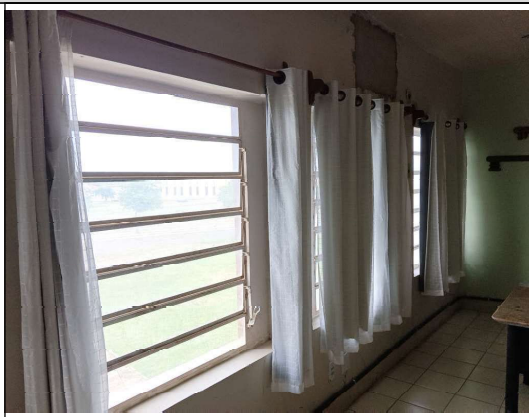
Foto 21 - Esquadrias metálicas a recuperar.
