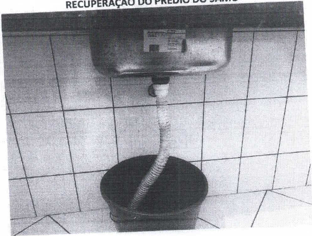
Figura 5 – SIFÃO PIA COZINHA
