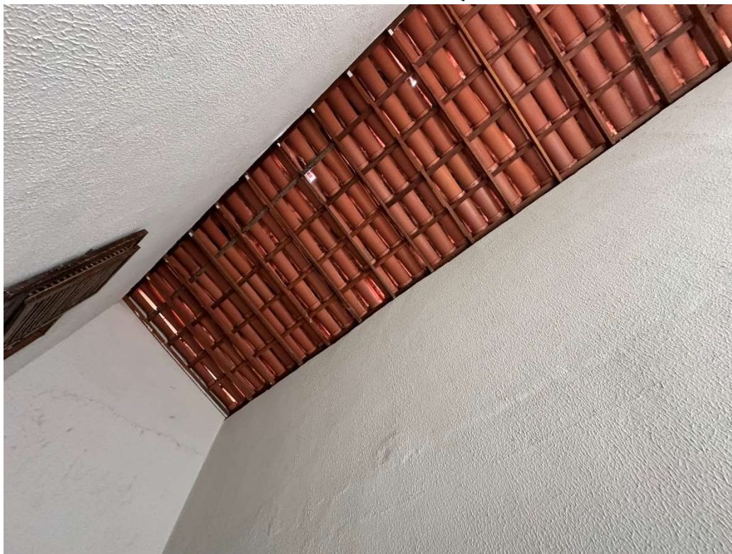
Figura 7 – TELHAS FASTADAS HALL
