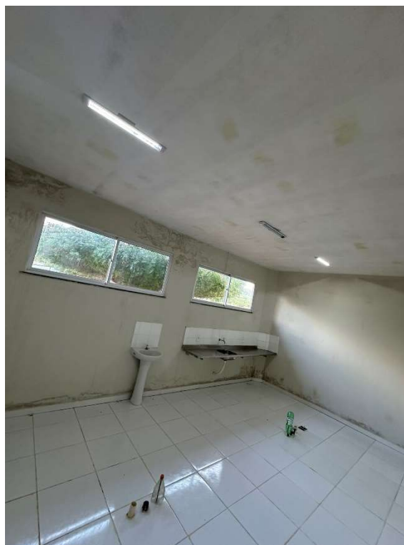
Figura 10 – INFILTRAÇÃO / LUMINÁRIA COM CURTO-CIRCUITO
