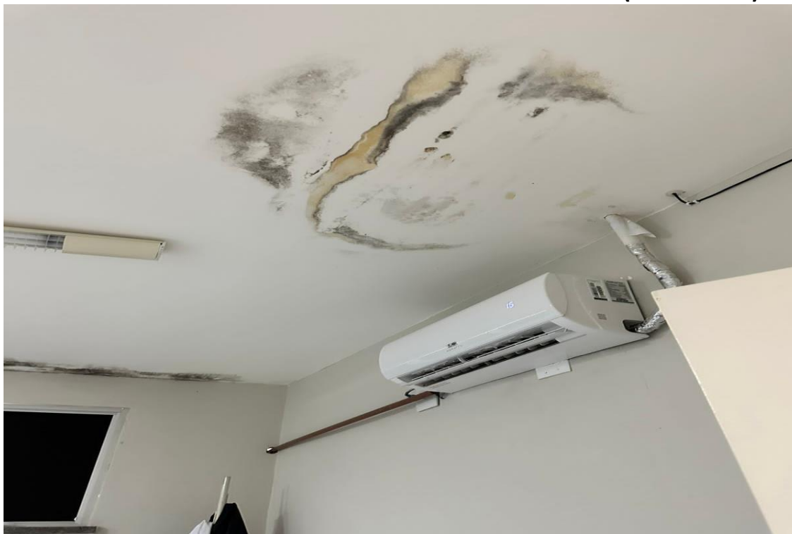
Figura 7 – PINTURA TETO - DANIFICADA
