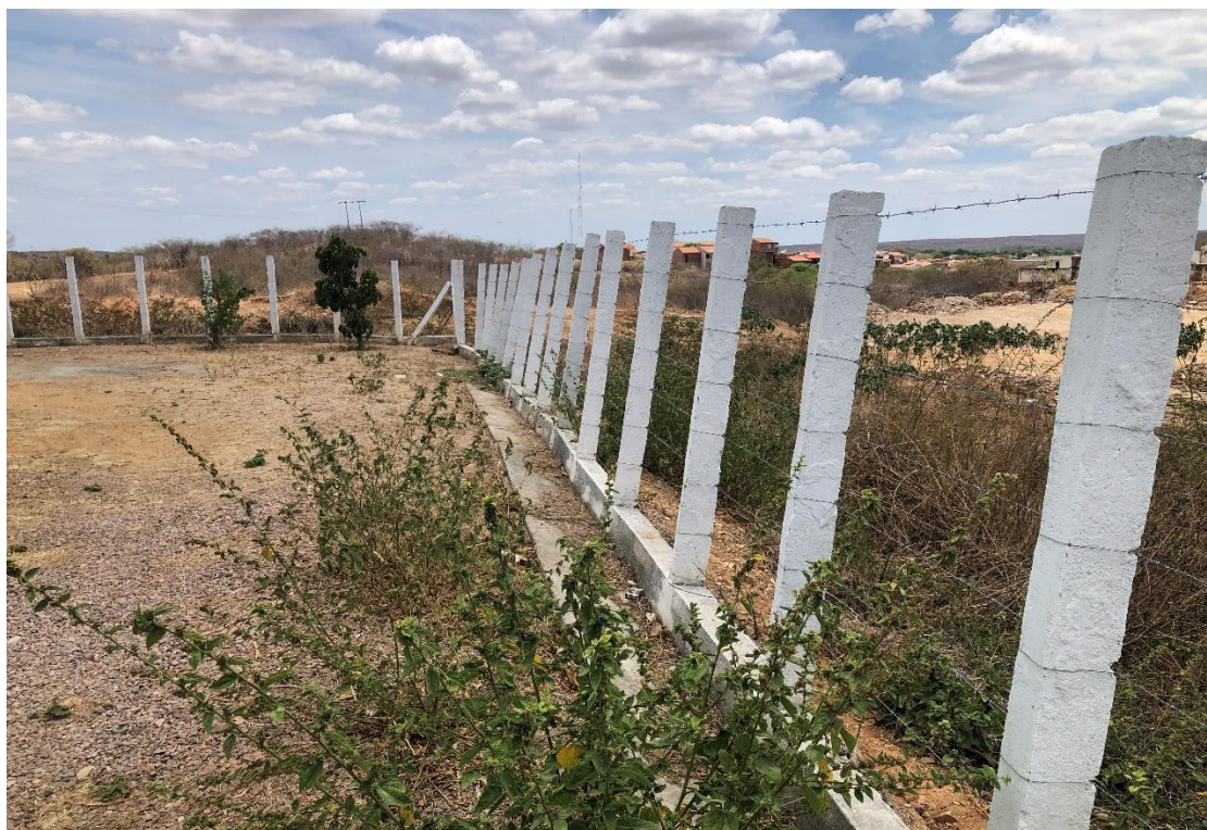
Figura 12 – CERCA DE PROTEÇÃO – DANIFICADA
