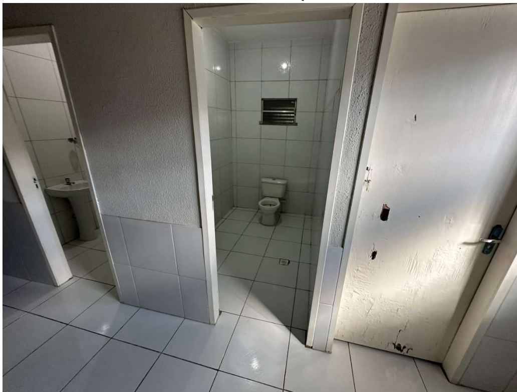
Figura 5 – PORTA DANIFICADA / BANHEIRO SEM PORTA
