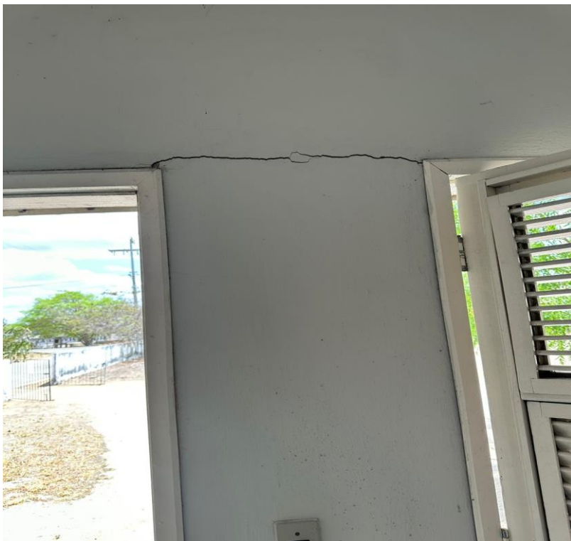
Figura 3 – ALVENARIA COM RACHADURA
