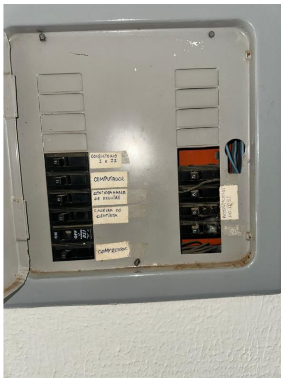
Figura 5 – QUADRO E DISJUNTORES
