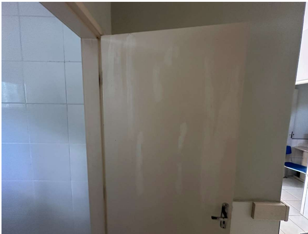
Figura 7 – PORTAS PINTURA DESGASTADA
