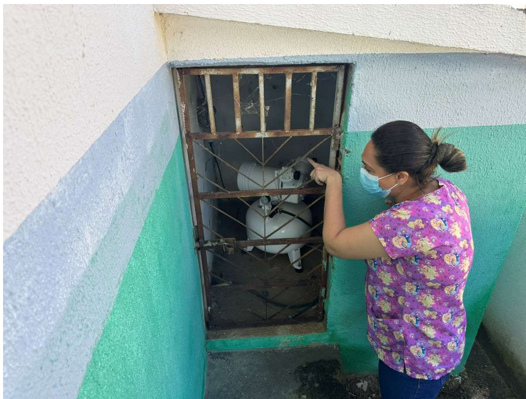
Figura 6 – INSTALAÇÃO EXPOSTA COMPRESSOR
