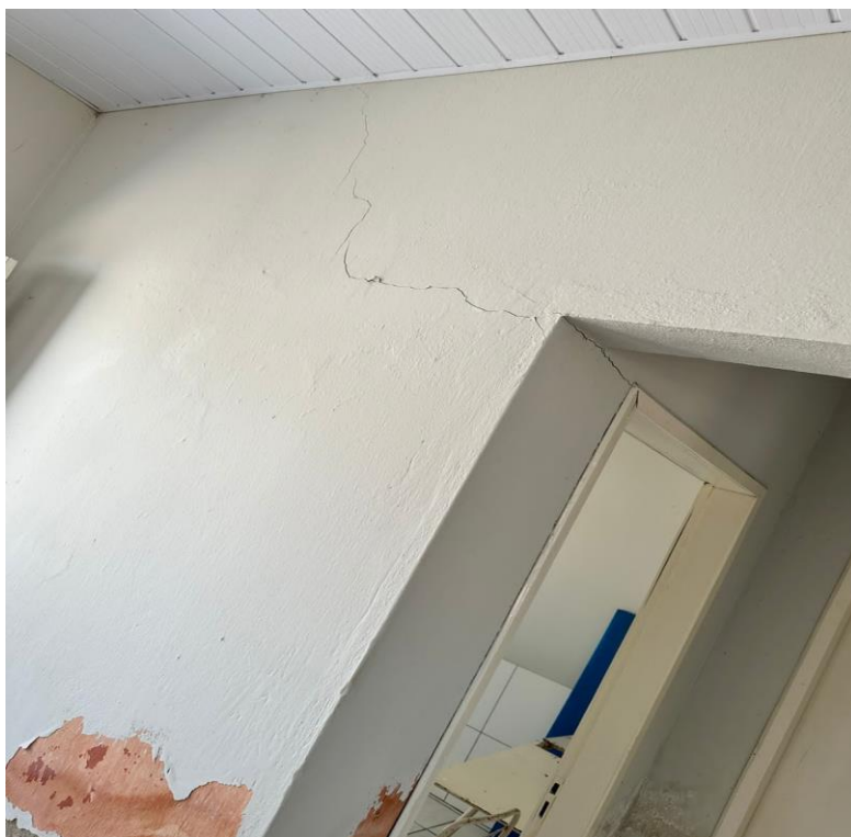
Figura 4 – ALVENARIA COM RACHADURA
