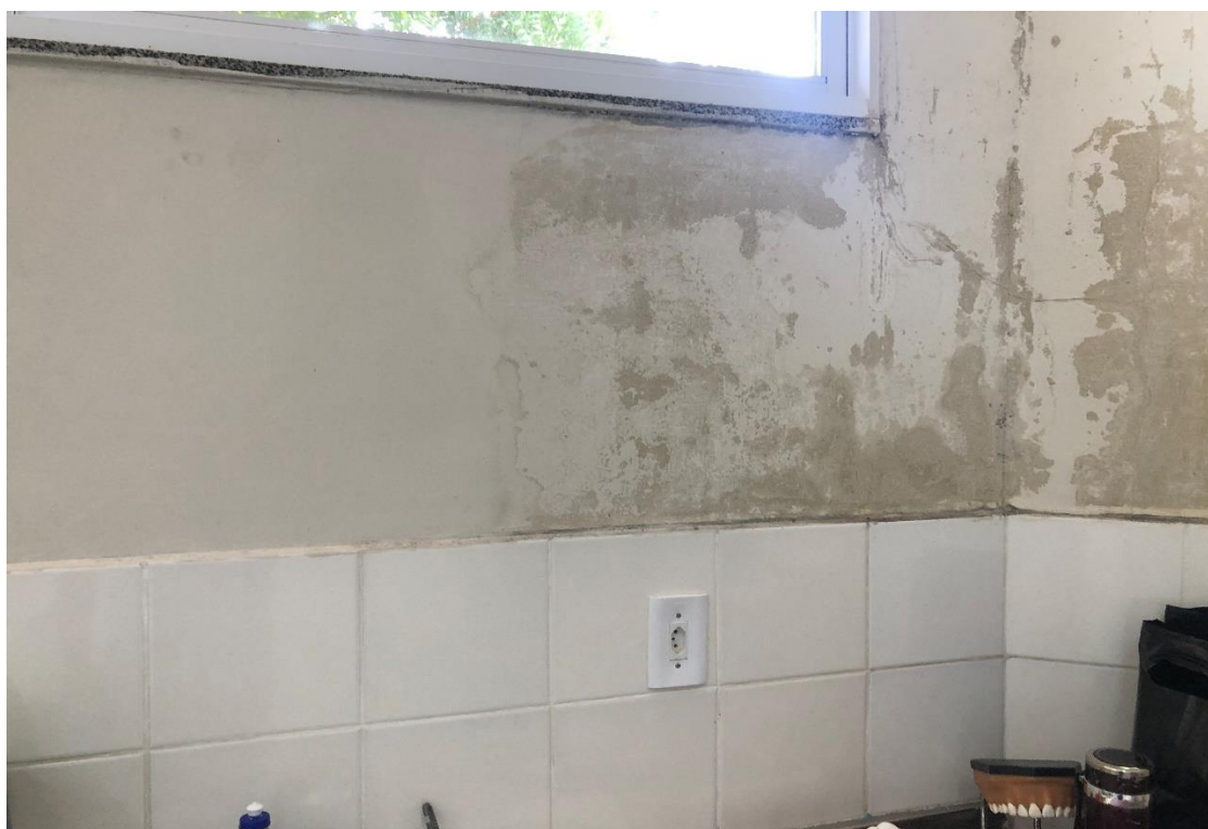
Figura 8 – PINTURA DANIFICADA – CONSULTÓRIO ODONTOLÓGICO
