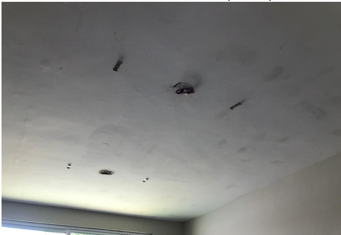
Figura 9 – FALTA DE LUMINÁRIAS
