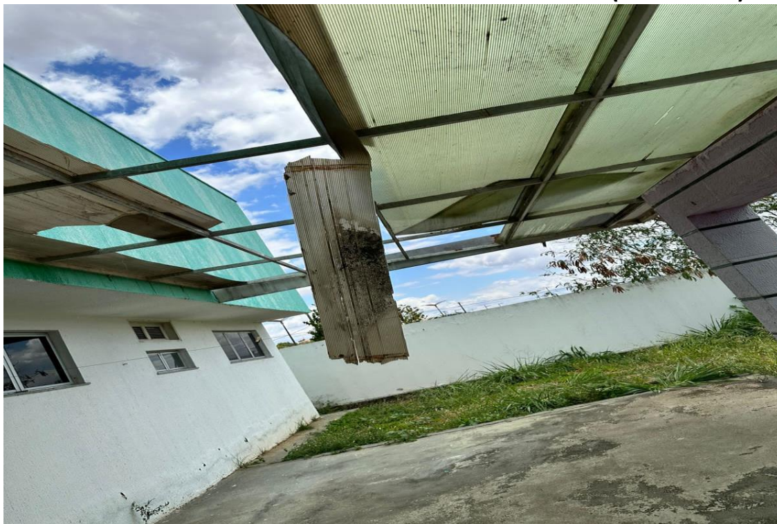
Figura 5 – CHAPA DE POLICARBONATO - DANIFICADA
