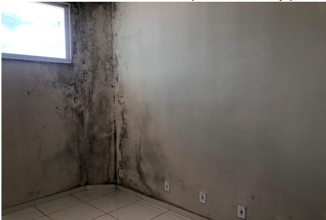
Figura 9 – PINTURA DANIFICADA – SALA DE PROCEDIMENTOS
