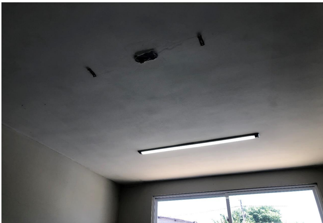
Figura 10 – FALTA DE LUMINÁRIAS
