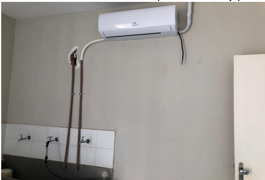
Figura 7 – AR-CONDICIONADO – INSTALAÇÃO E DRENOS
