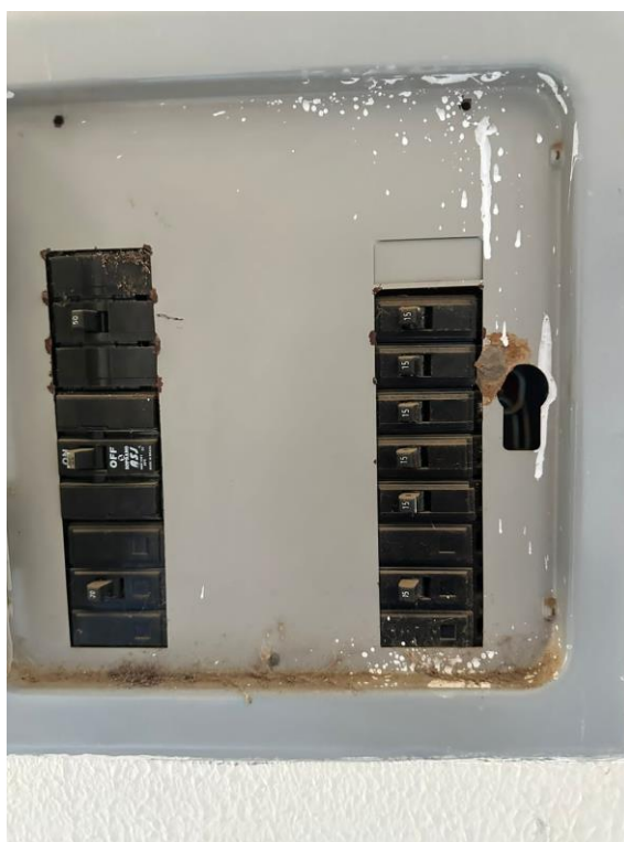
Figura 6 – QUADRO E DISJUNTORES
