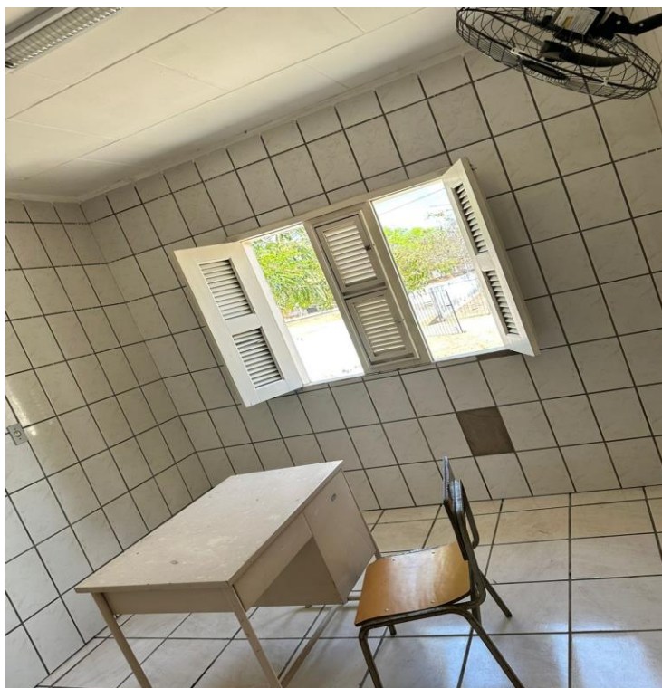
Figura 6 – REVESTIMENTO CERÂMICO QUEBRADO
