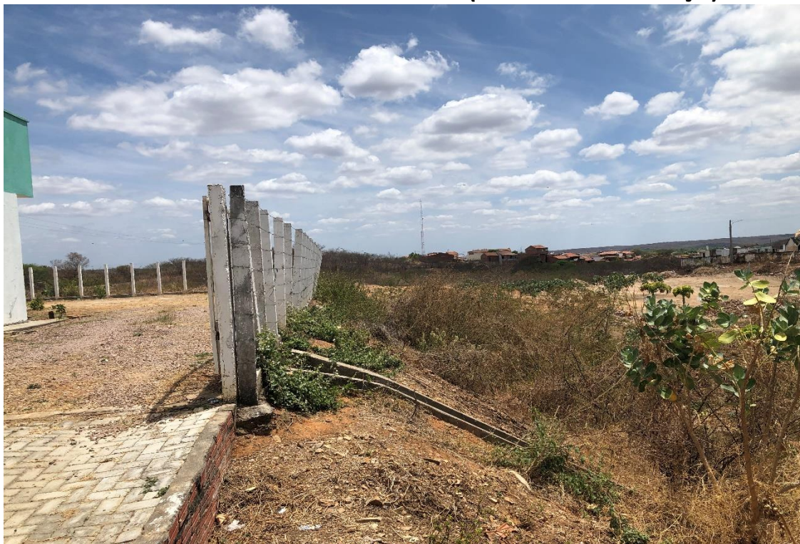
Figura 11 – CERCA DE PROTEÇÃO – DANIFICADA
