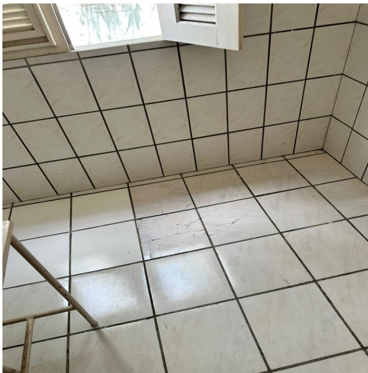
Figura 5 – PISO CERÂMICO QUEBRADO
