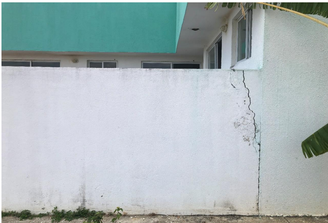
Figura 6 – ALVENARIA – COM RACHADURA
