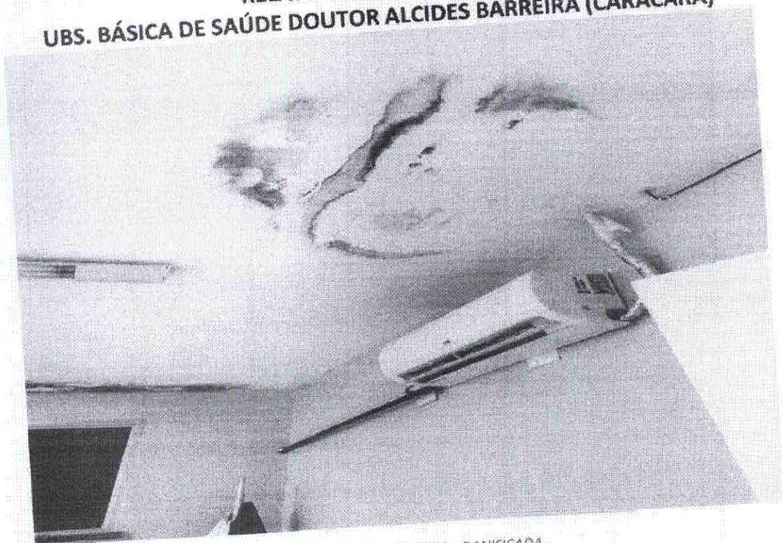
Figura 7 – PINTURA TETO – DANIFICADA
