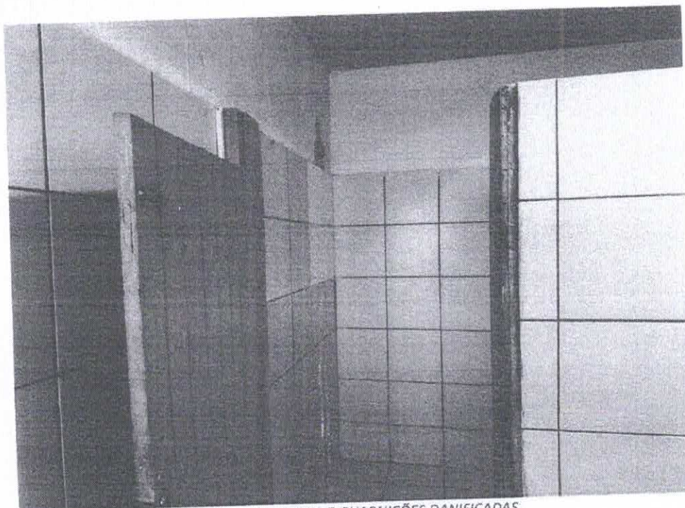
Figura 6 – PORTA E GUARNIÇÕES DANIFICADAS
