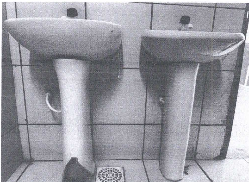
Figura 2 – LOUÇAS LAVATÓRIO QUEBRADAS
