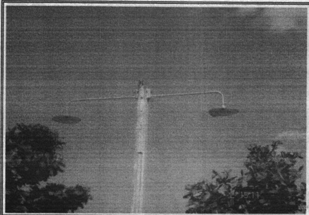
Foto 03 - Instalação elétrica com problema.
