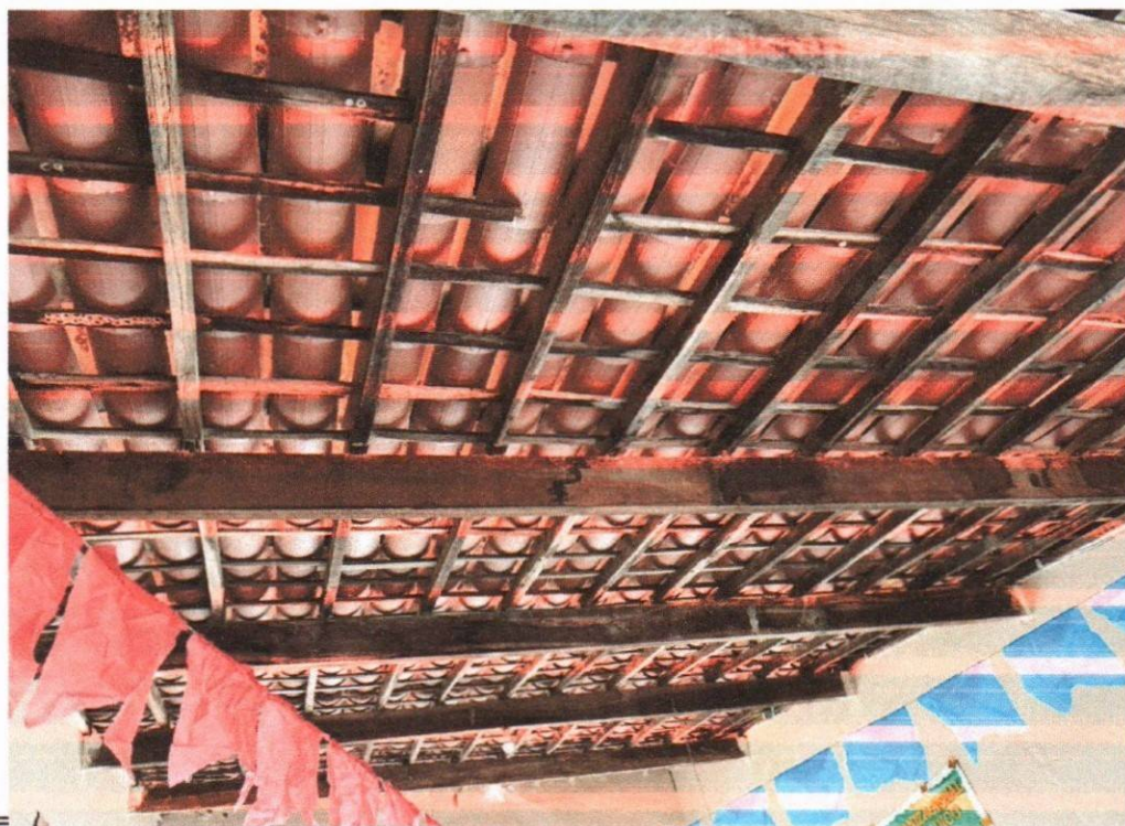
Foto 04-Vista telhado com defeito
