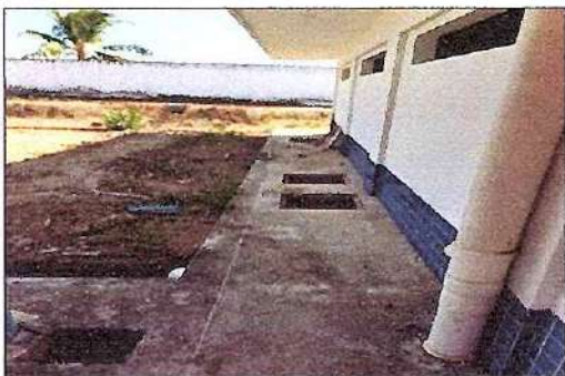
TAMPA DE CAIXAS DE PASSAGEM
