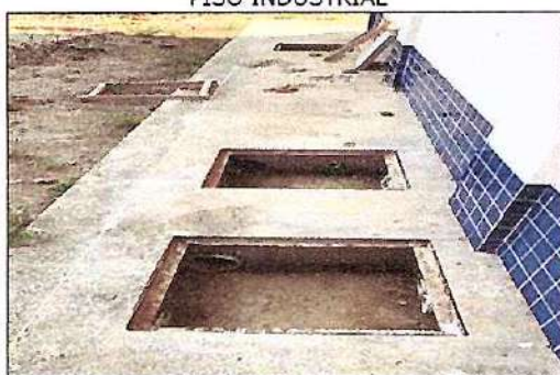
TAMPA DE CAIXA DE PASSAGEM
