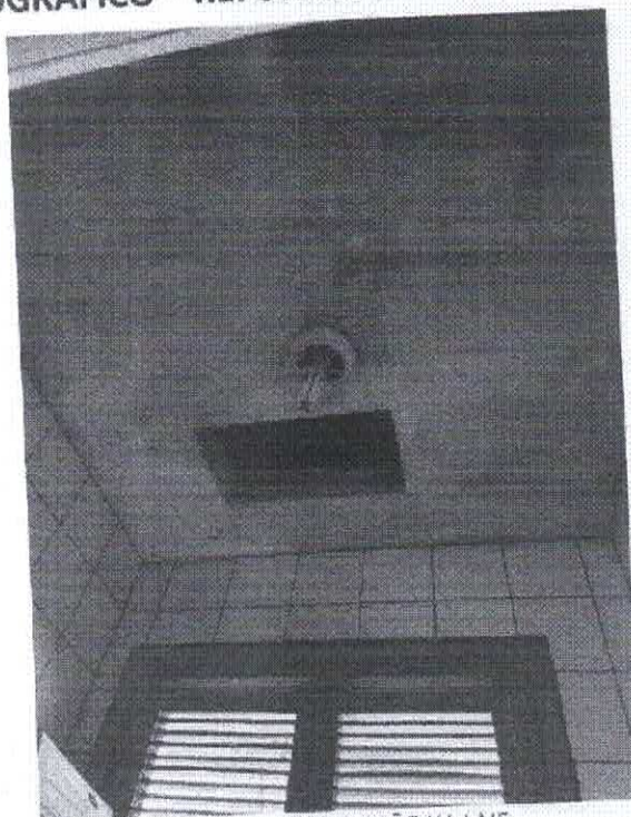
Figura 5 – INFILTRAÇÃO NA LAJE
