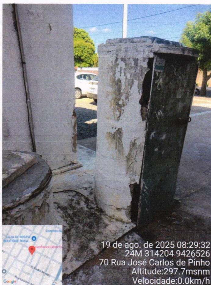
Figura 2 - Abrigo do quadro de Comando Deteriorado
