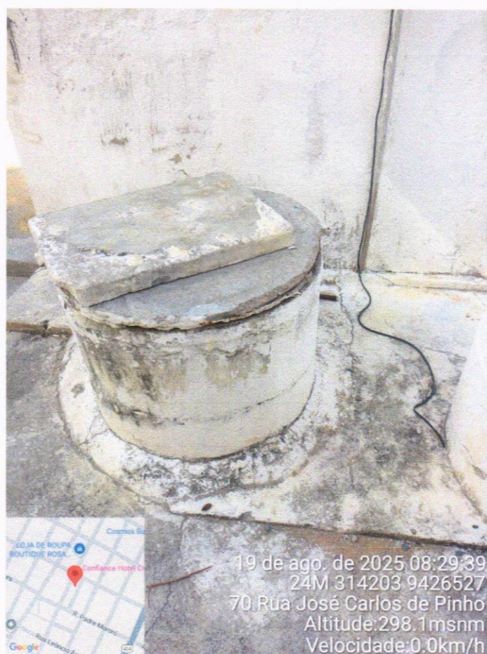
Figura 4 - Proteção do Poço profundo
