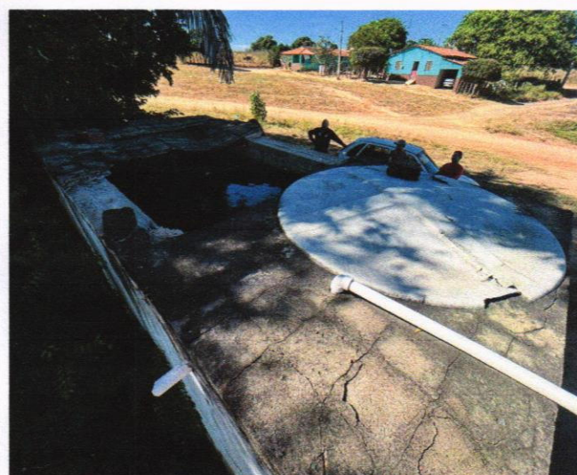
Figura 4 - Reservatório Exposto a Agentes Externos e Sujeito a Contaminação da Água
