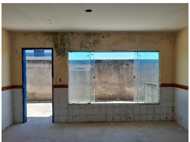
Infiltração na parede e teto da Pré-escola
