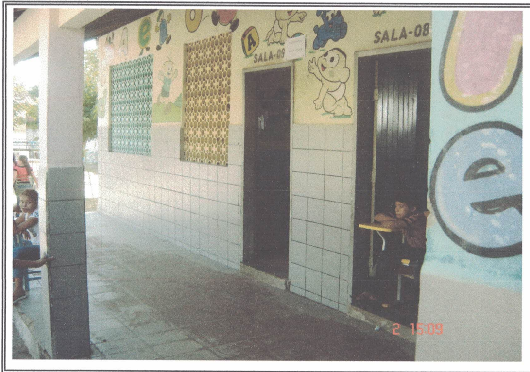
Foto 07 - Vista do piso da circulação danificado.
