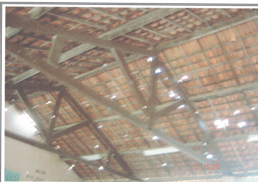
Foto 02- Telhado precisando de retelhamento.
