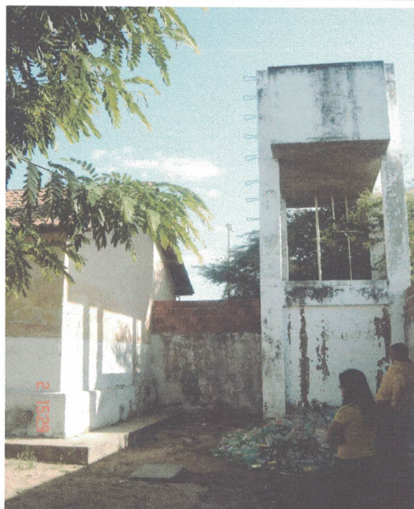
Foto 05 - Caixa D'água com infiltração.
