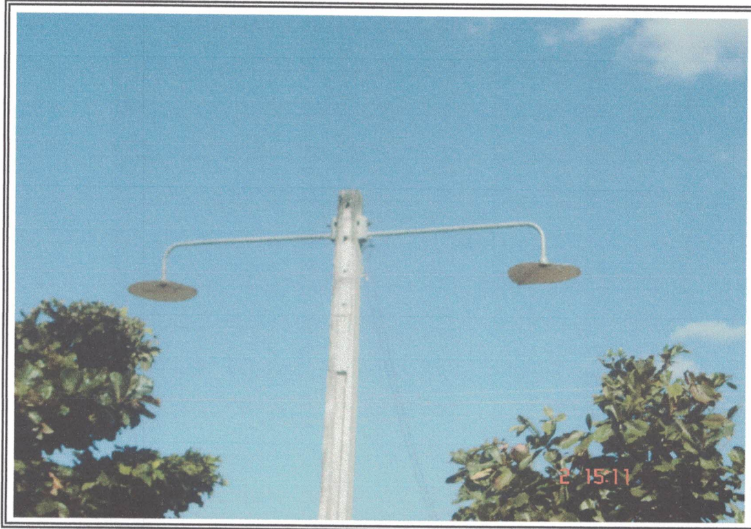
Foto 03 - Instalação elétrica com problema.
