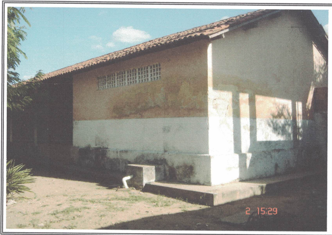
Foto 01 - Vista da pintura danificada.
