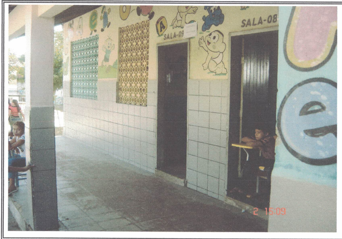
Foto 07 - Vista do piso da circulação danificado.
