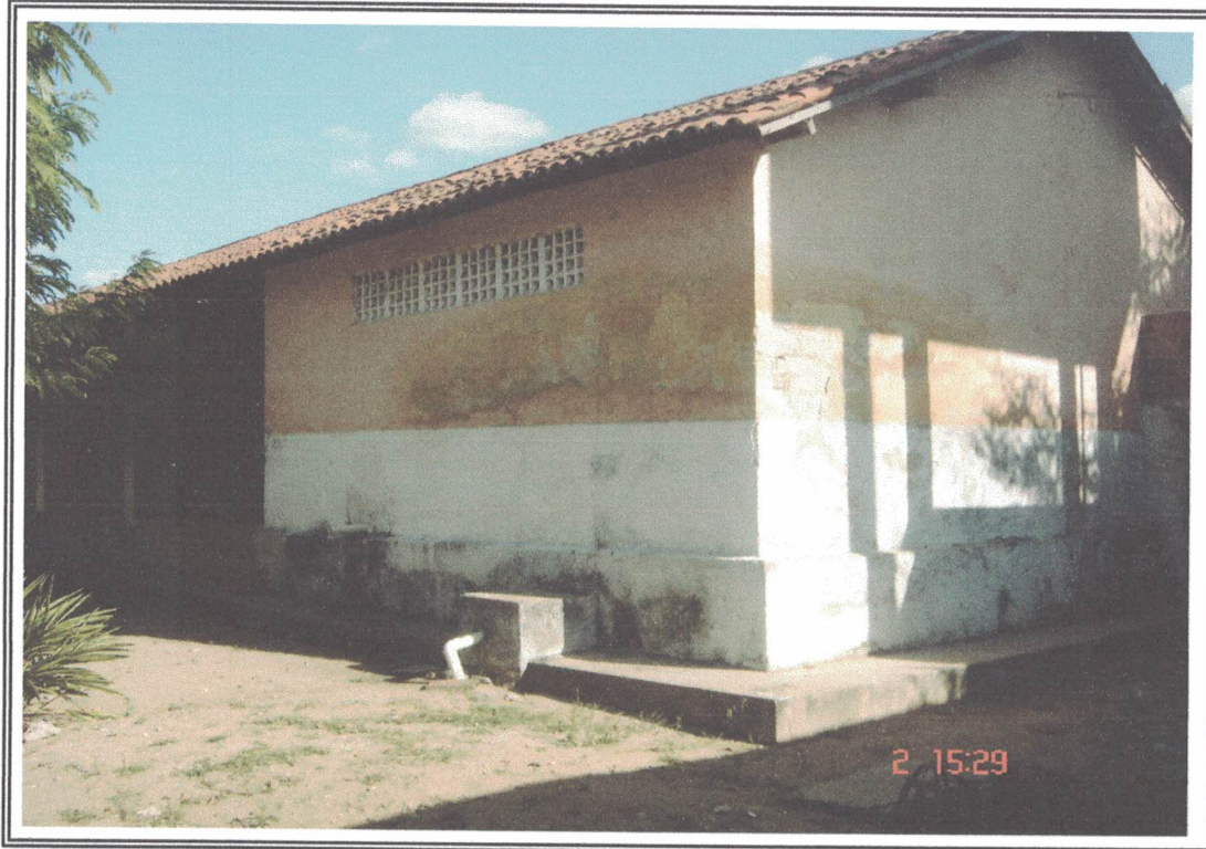
Foto 01 - Vista da pintura danificada.
