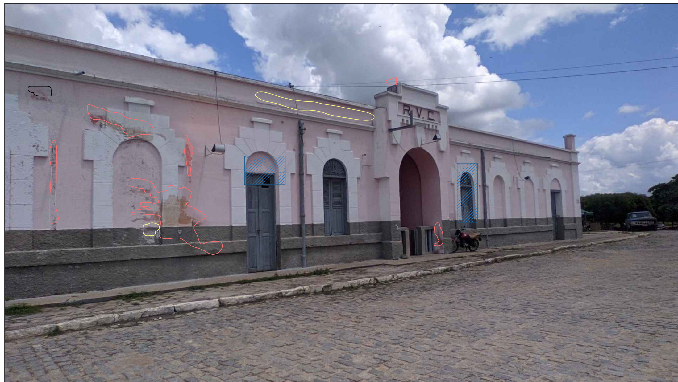
DETALHE DANOS FACHADA EM PERSPECTIVA 02 Esc.: S/E
