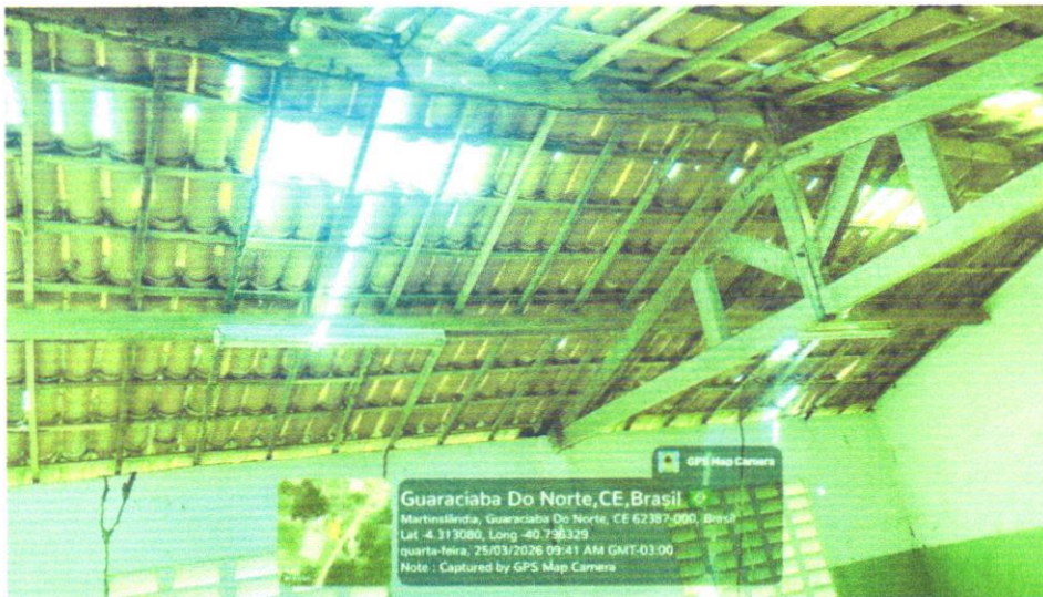
FOTO 05: Demonstração de inatividade da edificação existente.
