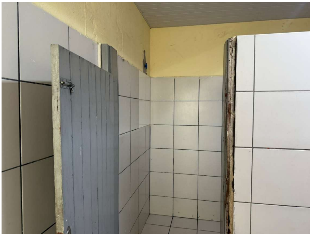
Figura 6 – PORTA E GUARNIÇÕES DANIFICADAS
