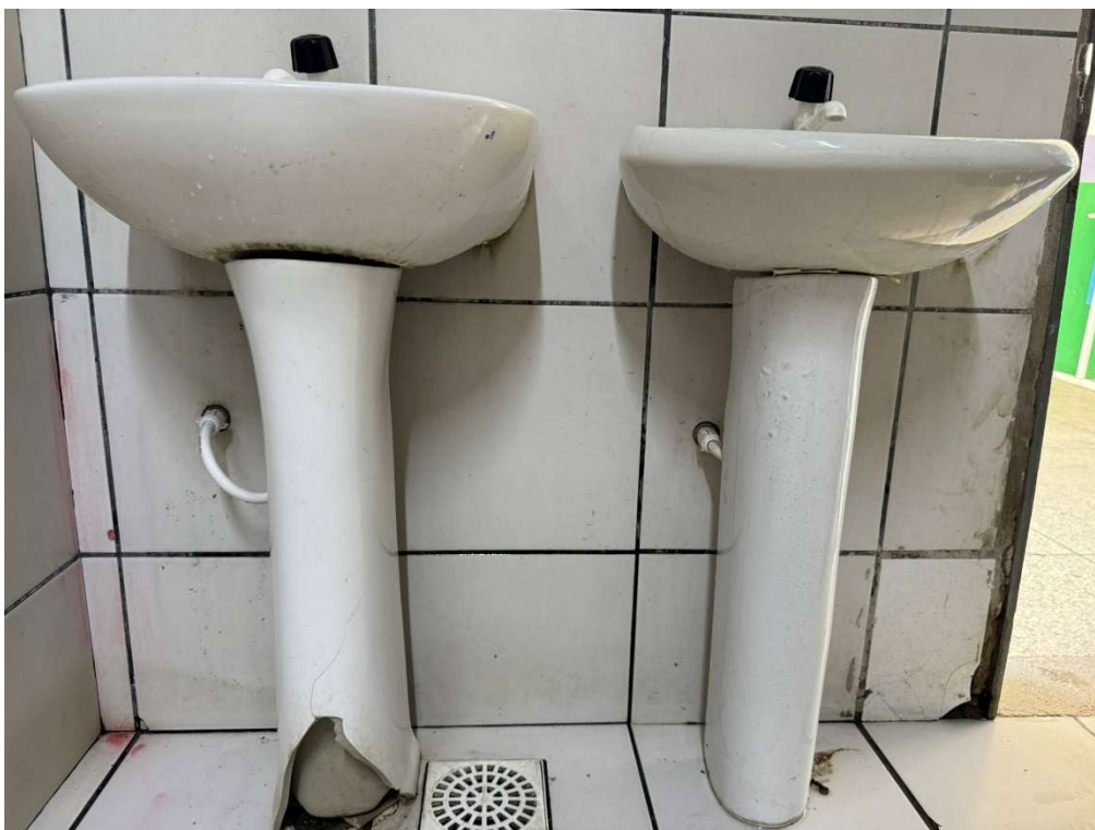
Figura 2 – LOUÇAS LAVATÓRIO QUEBRADAS
