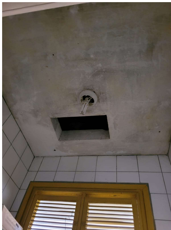
Figura 5 – INFILTRAÇÃO NA LAJE
