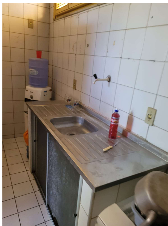
Figura 6 – INSTALAÇÕES HIDRÁULICAS E ELÉTRICAS DANIFICADAS
