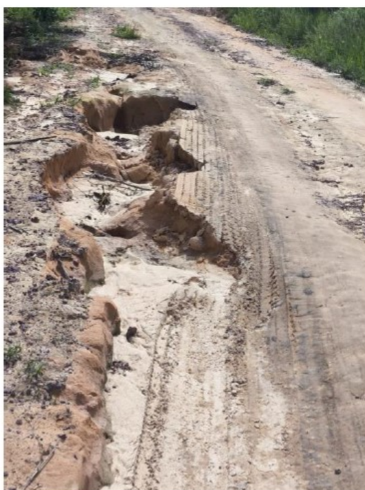
COMUNIDADE PARQUE DAS ARARAS, TRECHO DA TERRA DO SR. MINEIRO
