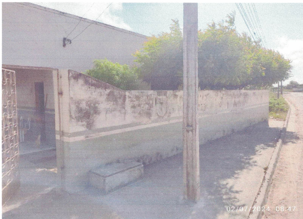
Foto 12- Vista da pintura danificada
