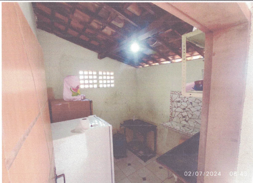
Foto 10-Vista das portas com defeito
