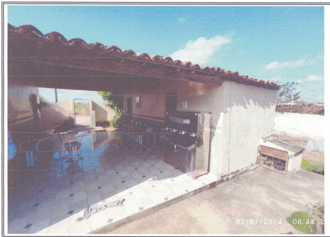
Foto 05 - Vista pintura danificada
