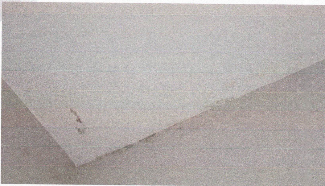
Figura 11: Presença de infiltrações na laje – imagem 11.
