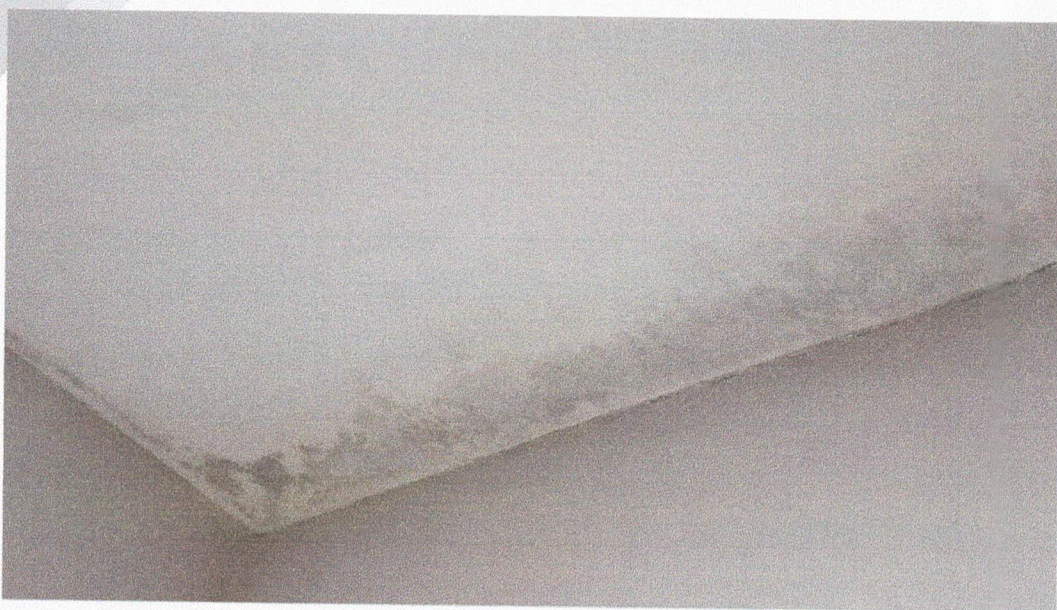
Figura 3: Presença de infiltração na laje – imagem 3.
