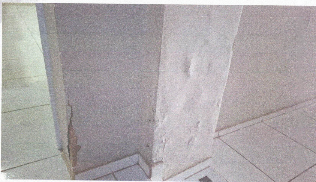
Figura 15: Presença de umidade na alvenaria – imagem 15.
