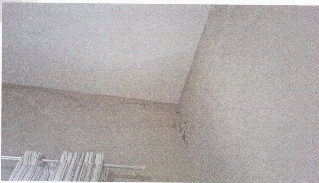
Figura 5: Presença de trinca e mofo na alvenaria – imagem 5.
