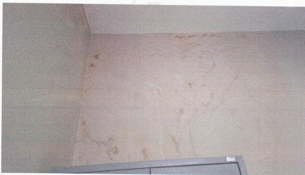
Figura 4: Presença de mofo aparente (infiltração) – imagem 4.
