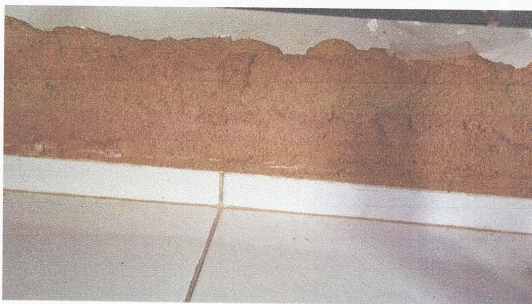
Figura 10: Umidade em pé de parede – imagem 10.
