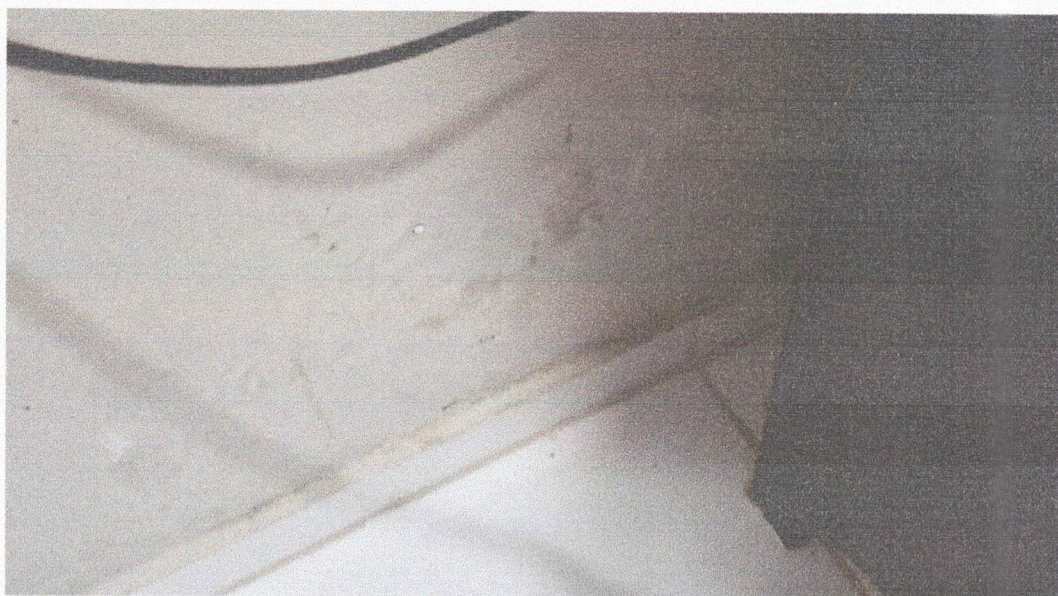
Figura 08: Presença de infiltrações vindo da viga baldrame – imagem 08.
