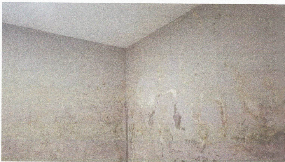
Figura 1: Presença de trinca e mofo na alvenaria – imagem 1.
