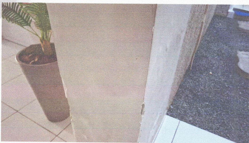
Figura 13: Presença de umidade na parede – imagem 13.
