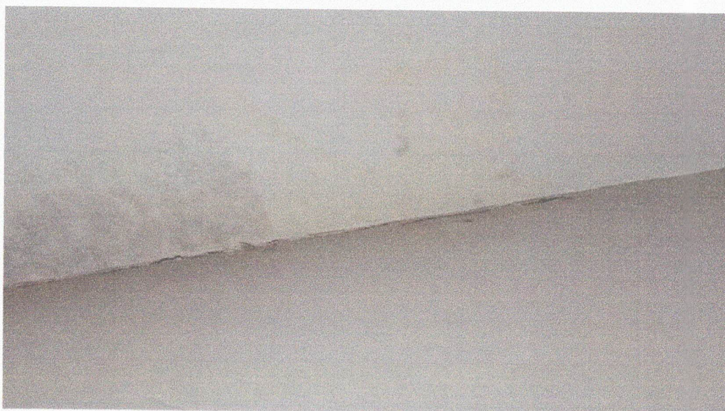
Figura 12: Presença de infiltrações na laje – imagem 12.
