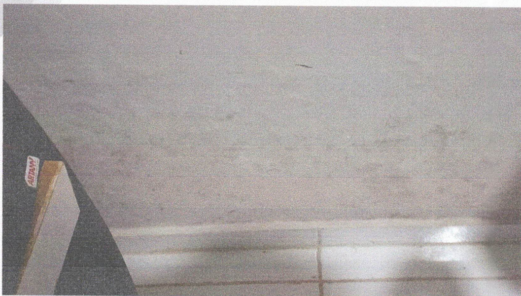
Figura 07: Presença de infiltrações vindo da viga baldrame – imagem 07.
