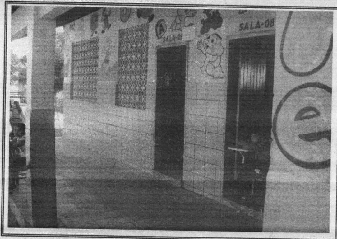
Foto 07 - Vista do piso da circulação danificado.
