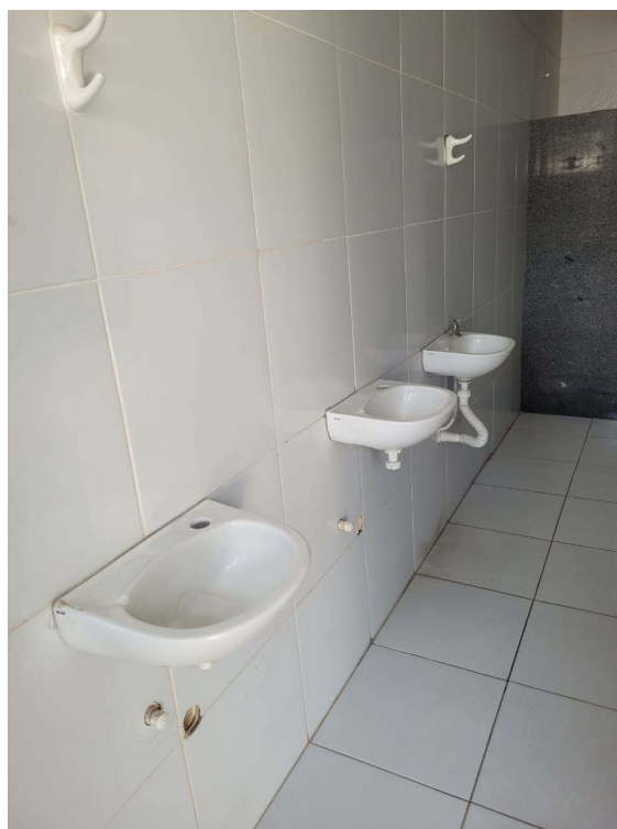
Figura 6 – INSTALAÇÕES HIDRÁULICAS DANIFICADAS
