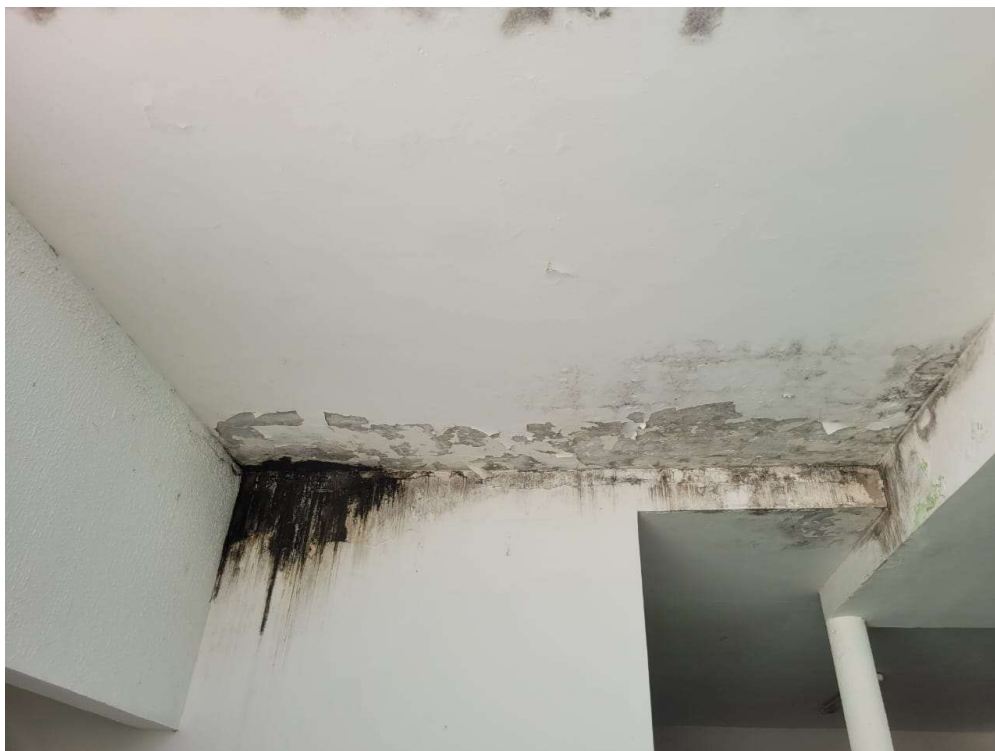
Figura 5 – INFILTRAÇÃO NA LAJE
