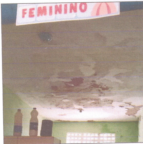
Figura 7: EEB F co J. de Sousa Filho - Infiltração em laje.
