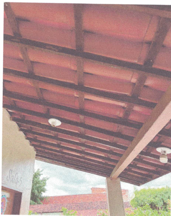
Foto 01 - Vista onde sera colocado lampada
