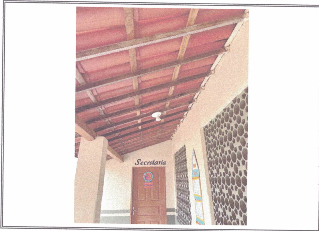
Foto 09 - Vista salas com instalacao danificada
