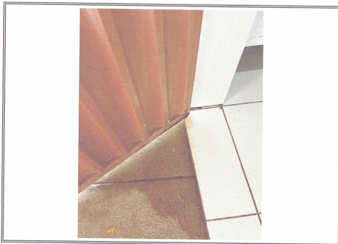
Foto 10-Vista da portao defeito
