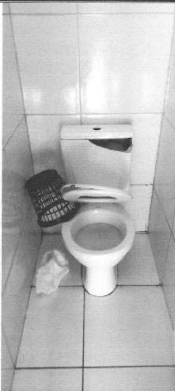
Figura 17 – VASOS DANIFICADOS E INSTALAÇÕES SEM FUNCIONAMENTO
