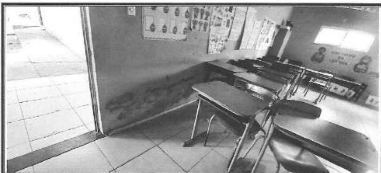
Figura 05 – DETERIORAÇÃO DO REVESTIMENTO DAS SALA 2
