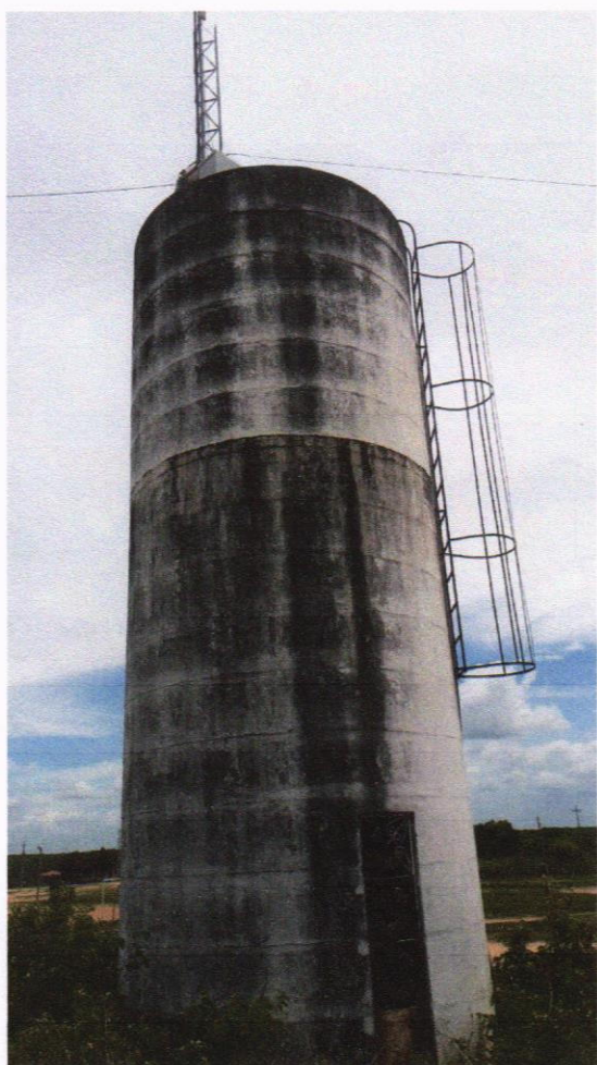
Figura 1 - Reservatório Elevado na Localidade de Apuí
