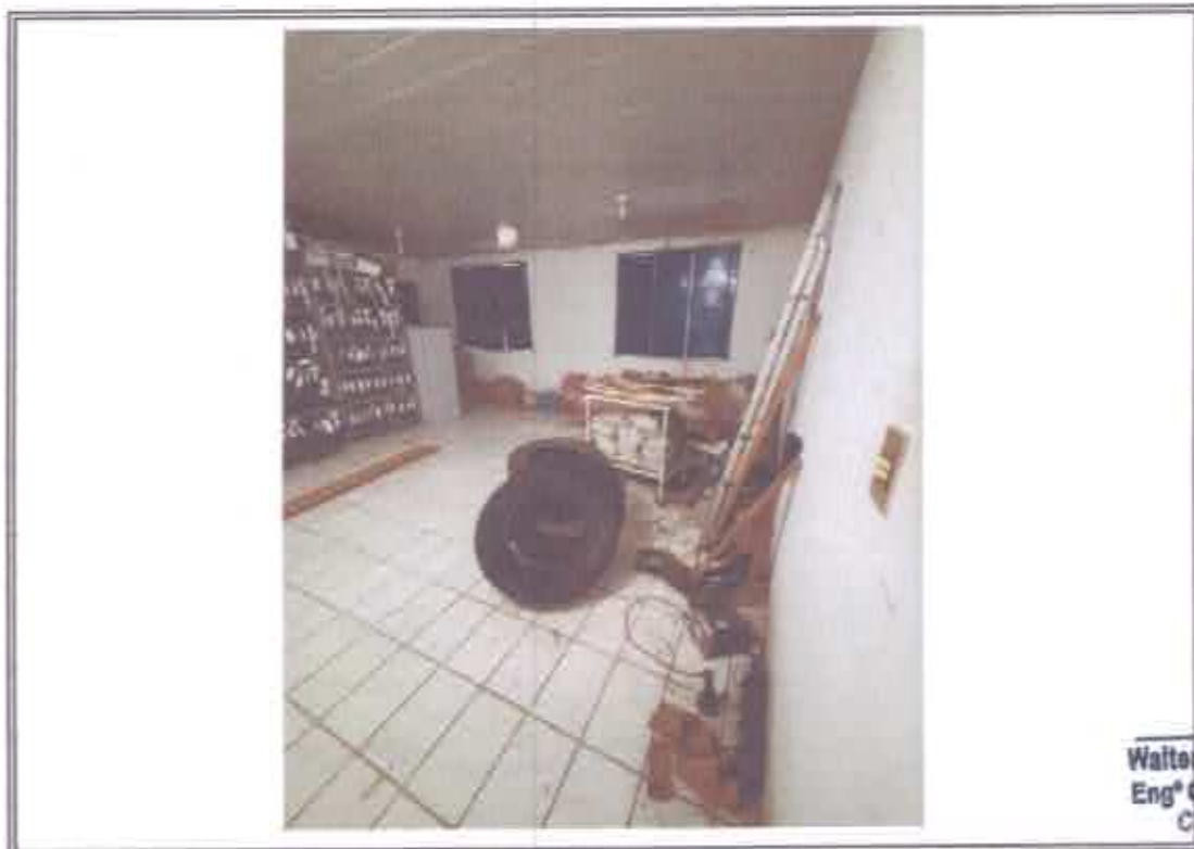
Foto 08- Vista do telhado danificado
