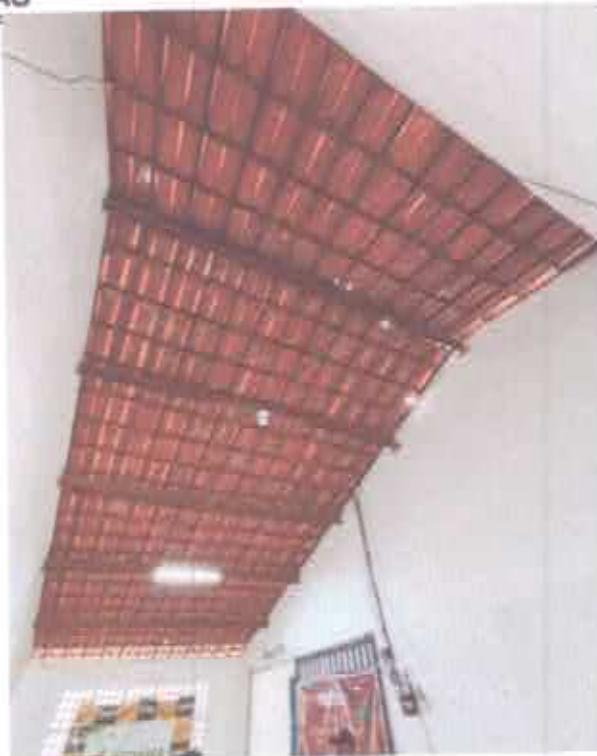
Foto 05 - Telhado com infiltração.
