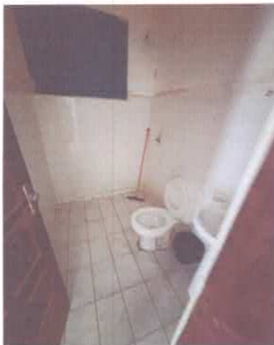
Foto 10- Vista wc sem funcionar
