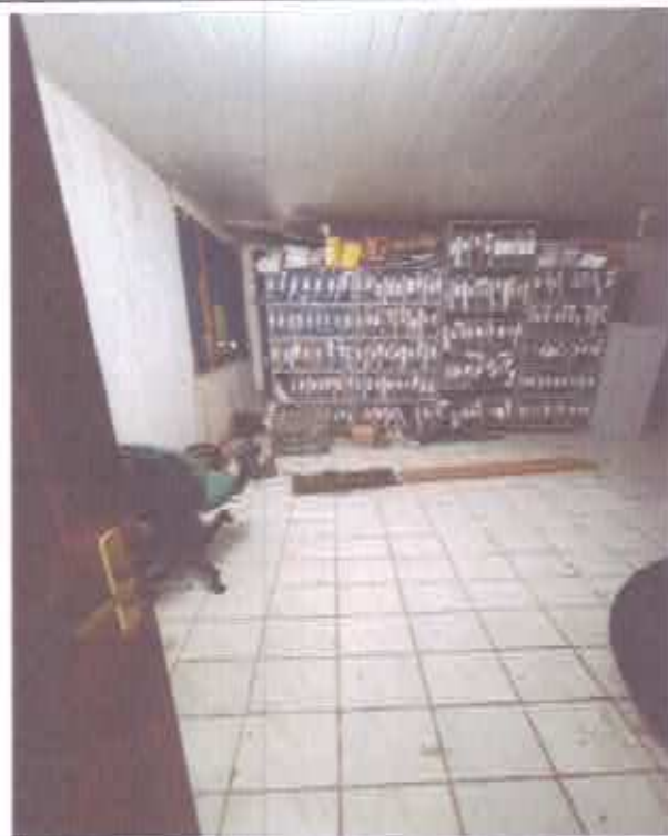
Foto 03 - Instalação elétrica com problema.
