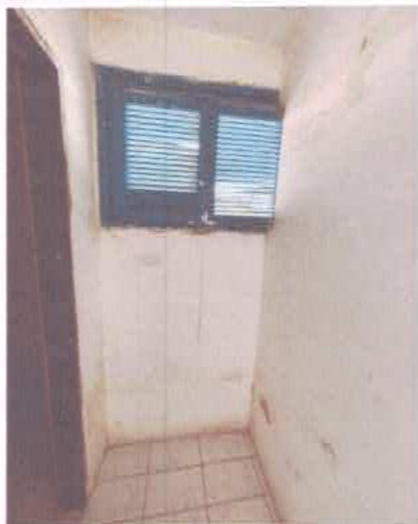
Foto 01 - Vista da pintura danificada.
