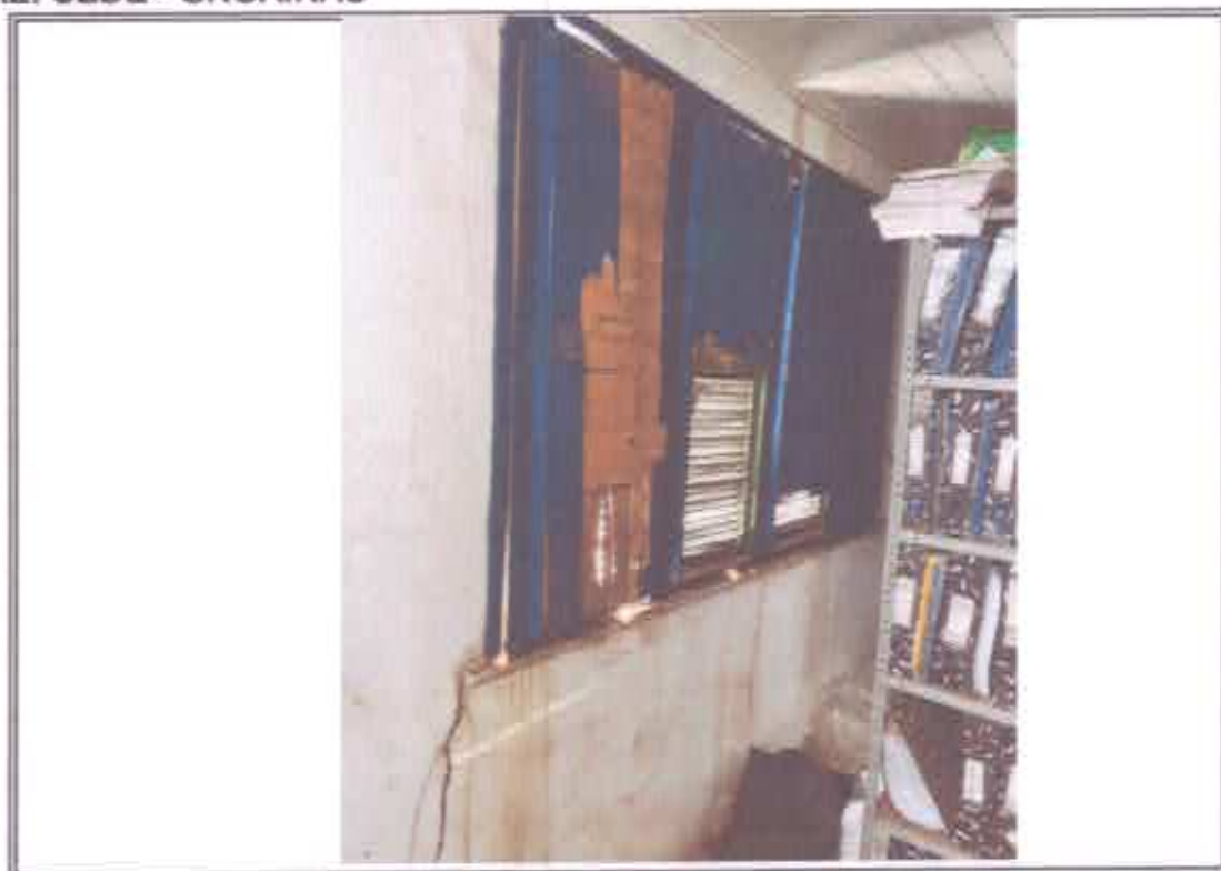
Foto 07 - Vista da janela danificado.
