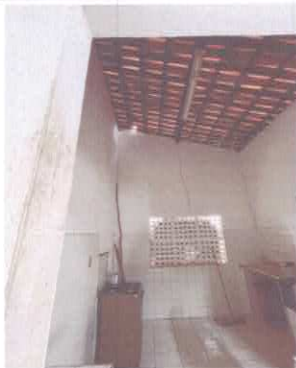
Foto 02- Telhado precisando de retelhamento.
