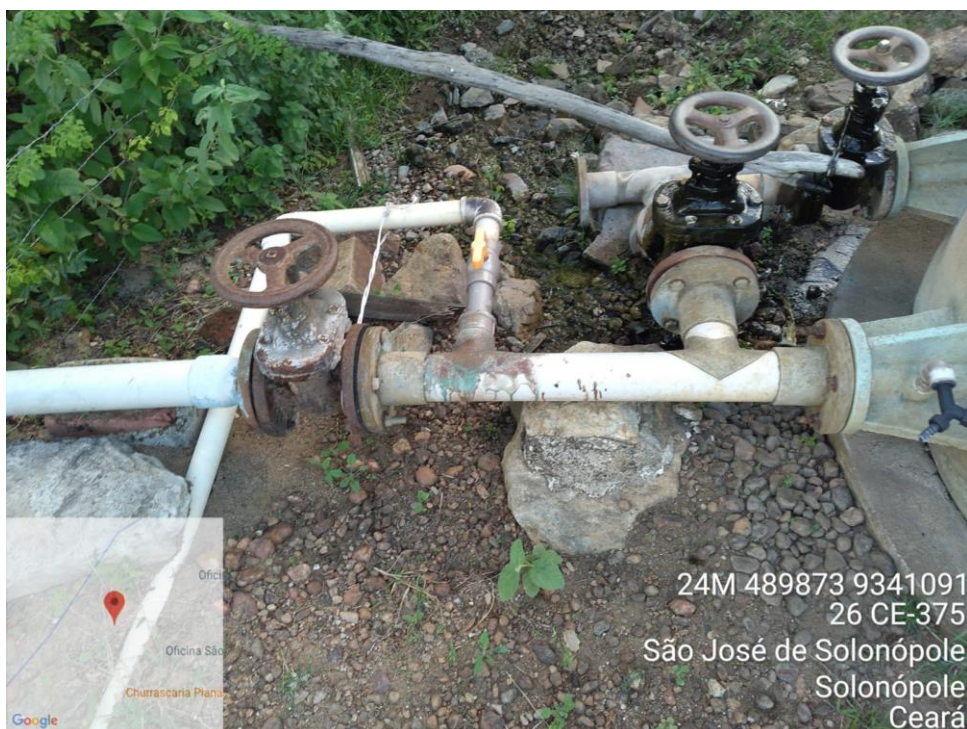
FIGURA 21 – CONEXÕES DA ETA
