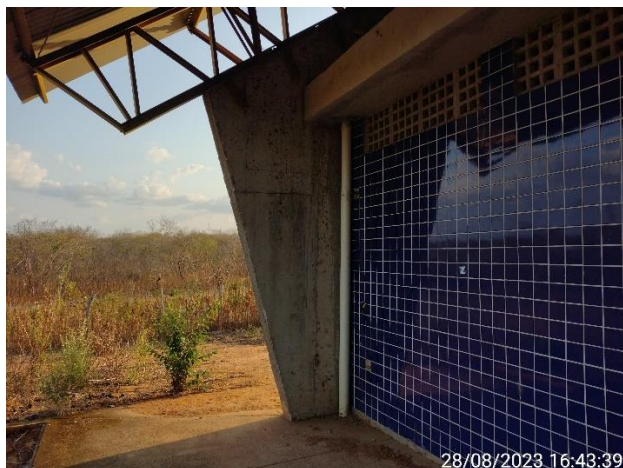
Figura 7 - Obra encontra-se em nível com o terreno;
