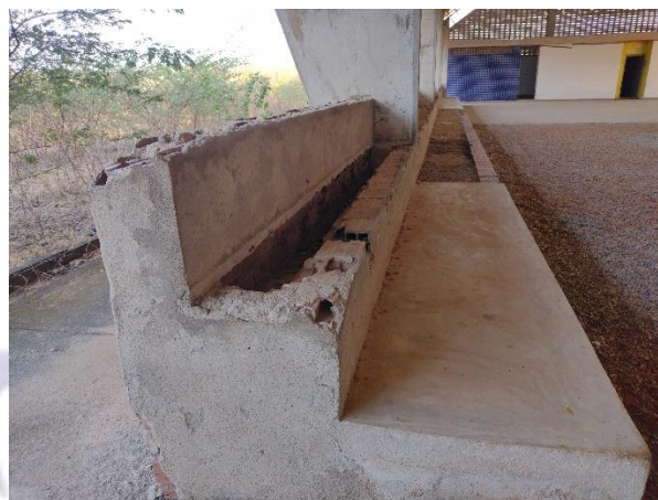
Figura 36 – Local da arquibancada sem alvenaria;
