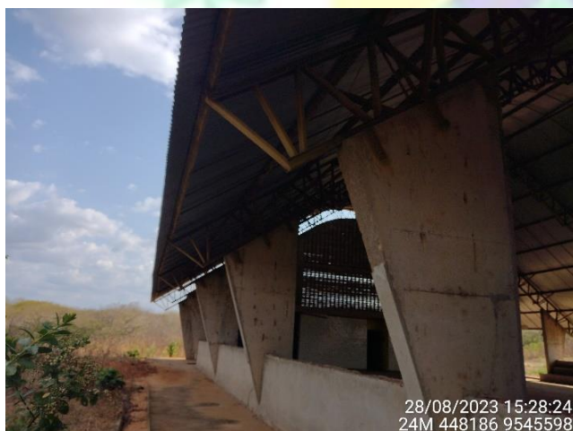
Figura 37 – O apoio das treliças metálicas nos pilares de concreto foi executado em desacordo com o projeto;
