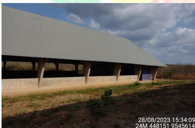
Figura 41 - Cobertura com suas devidas alterações vista de externamente;
