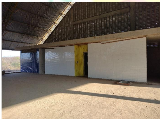
Figura 67 – A caixa d'água não foi instalada na cobertura;
