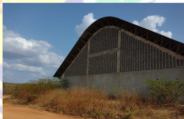
Figura 42 - Cobertura com suas devidas alterações vista de externamente;
