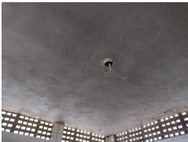
Figura 17 - Laje executada e sem nenhum tipo de manifestação patológica;
