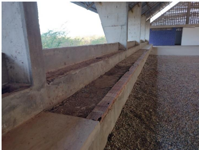
Figura 49 – Peça da arquibancada sem reboco;
