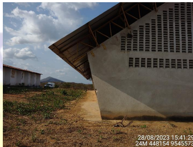
Figura 8 – Inclinação leve na área externa da obra;
