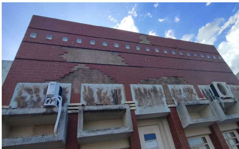
FOTO 02 – REVESTIMENTO CERAMICO DANIFICADO
