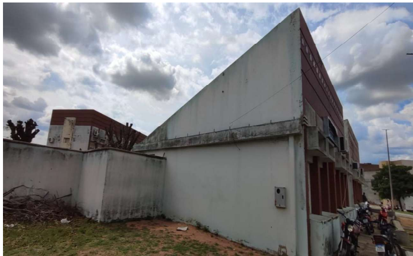
FOTO 17 – LOCAL DA INSTALAÇÃO DE JANELAS DA SALA 07
