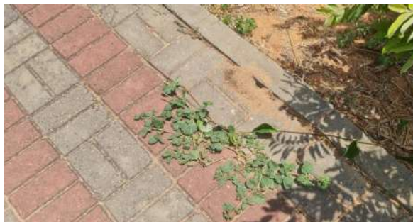
Figura 8 – Desalinhamento do meio fio.
