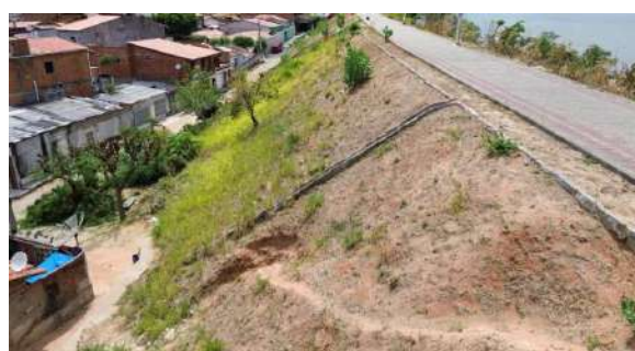
Figura 6 – Erosão no Talude.
