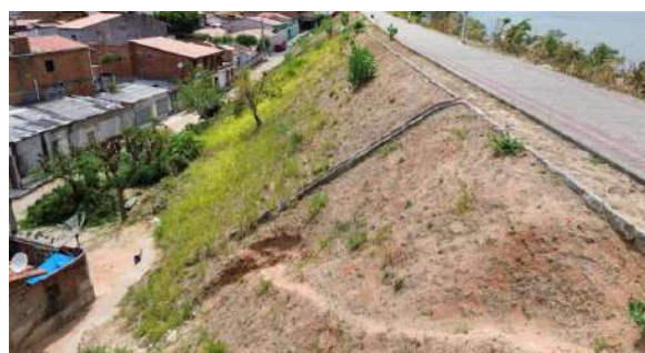
Figura 6 – Erosão no Talude.
