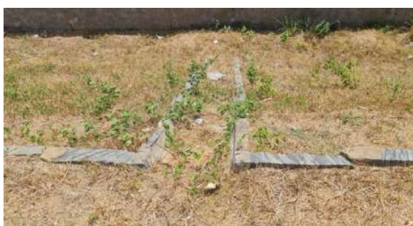
Figura 11 – Descida de água obstruída.
