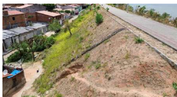
Figura 6 – Erosão no Talude.
