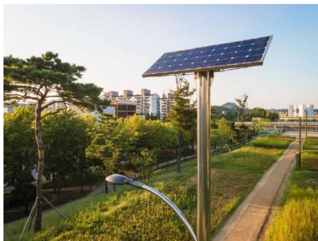
Figura 17 – Exemplo de postes com luminárias solares
