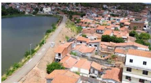
Figura 7 – Talude sem proteção vegetal.
